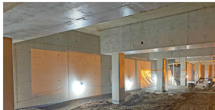
Muottien vesitiiveyden takaamiseksi PERI toimitti kohteeseen tarvittavan määrän vesi- ja kaasutiiviitä laippoja.
